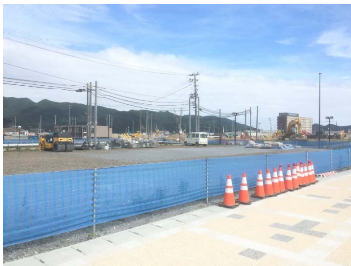
図表 7 大船渡駅前から南東方向の状況
