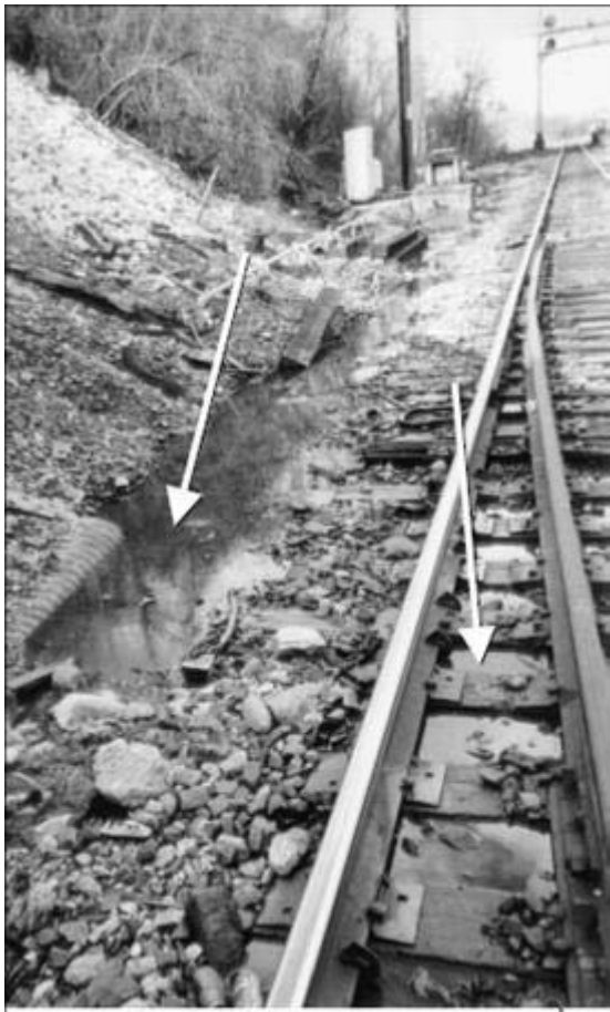
(北東回廊のペンシルバニア - フィラデルフィア間の鉄道敷地。排水が十分ではなく矢印の箇所に水がたまり、線路地盤を弱化させる)
