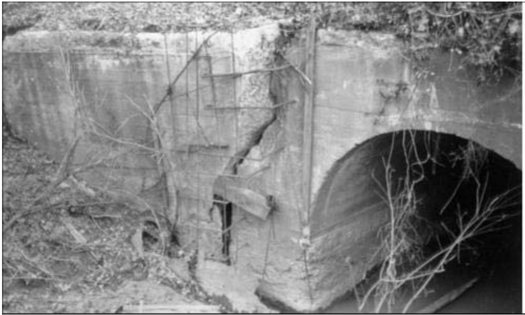
(ワシントン DC とペンシルバニアを結ぶ路線、メリーランド州内。氷結や融雪を繰り返し、ひびの入った橋脚)
